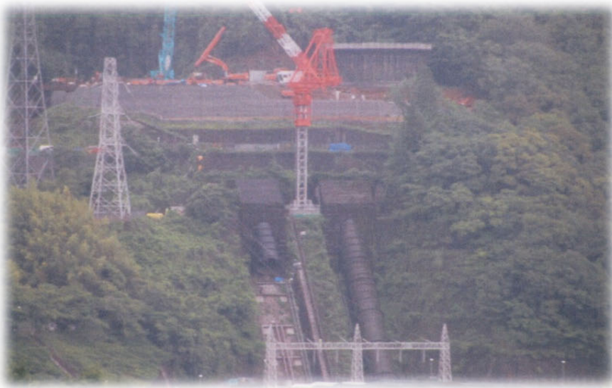
*岐阜丸山ダム水圧鉄管傾斜部②
